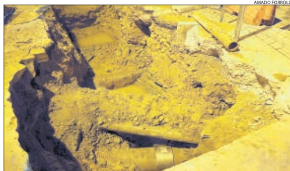
La canonada de la Bordeta afectada, ja reparada.
